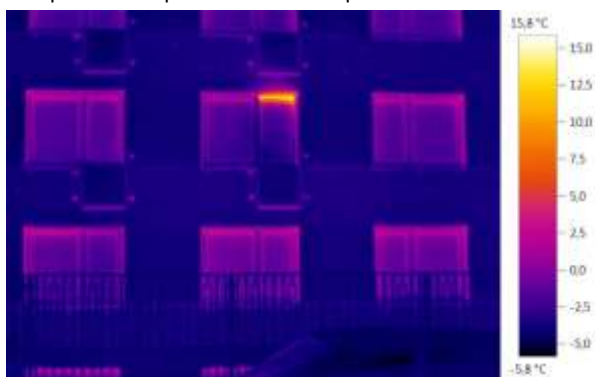
Zrušení balkonových dveří, vyzdění novým materiálem, tepelné mosty po odřezání zabraďí a nekvalitně dotaženou izolací
